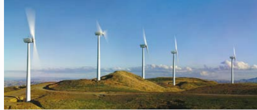
Te Rere Hau parque eólico atapa 1
